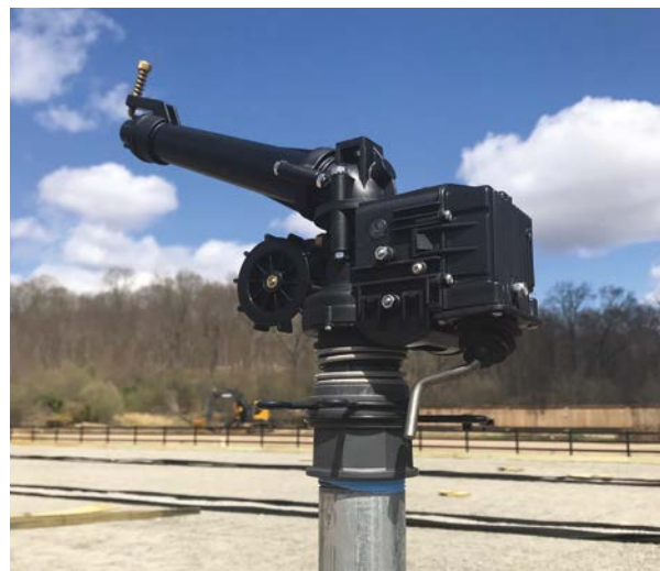
Εγκατεστημένος Ρότορας ST-1200-BR
